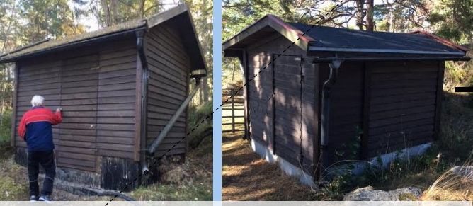
2 SAMMANKOPPLADE PUMPHUS TJÄNLIGT VATTEN Boende på Lisökälv har fått nycklar till husen. Kontaktperson: Gunnar Ygberg
